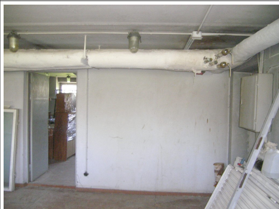
Ruumi lae all paiknevad isoleeritud veetorud
