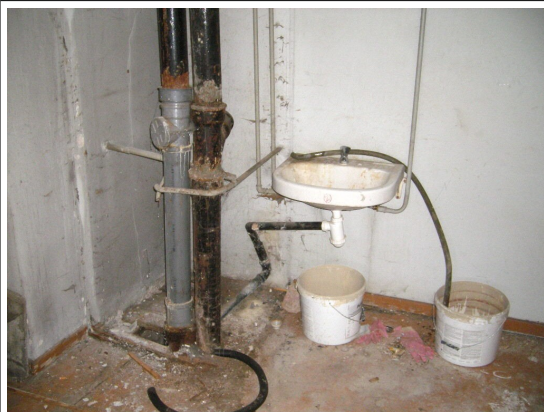
Olemas on veevarustus ja selle kõrval kulgevad ka kanalisatsioonitorud
